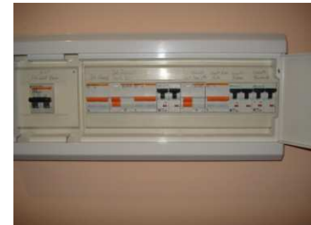
Imagen 4 :Cuadro eléctrico de protección en una vivienda. Compuesto por: ICP, IGA, PIAS e ID.
