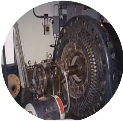
Imagen 1. Generadores eléctricos. Fuente: wikipedia . Creative Commons
